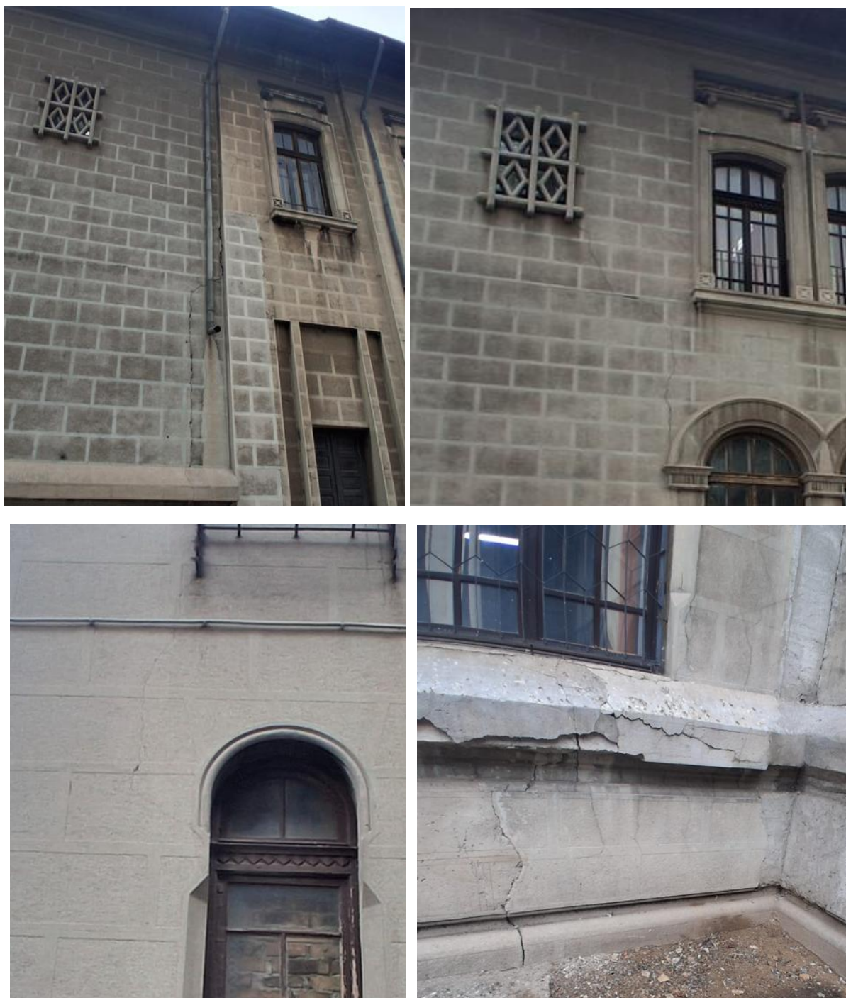
Fig.1. Degradări în fațade
