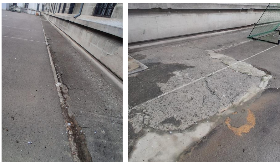
Fig.2. Fisuri și crăpături ale soclului și a trotuarului de protecție; degradări locale nestructurale ale materialelor aplicate pe fațadă
