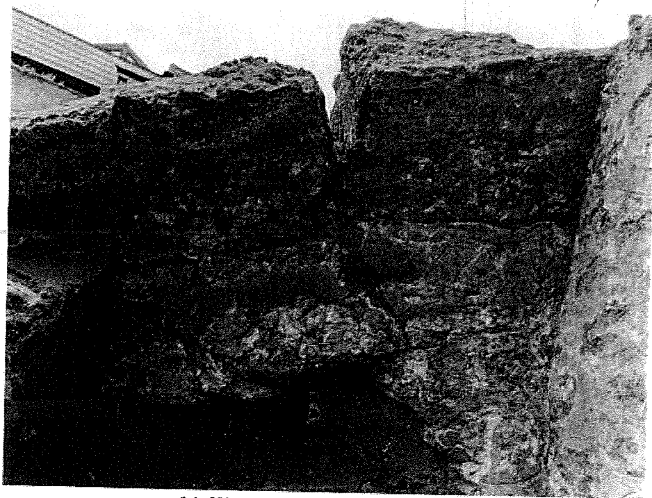
24. Hipogeu – detaliu boltă fracturată
