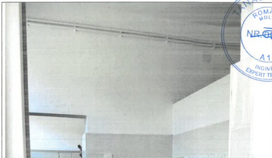
Fig. 2 – Crapaturi diagonale la nivelul peretilor de compartimentare
