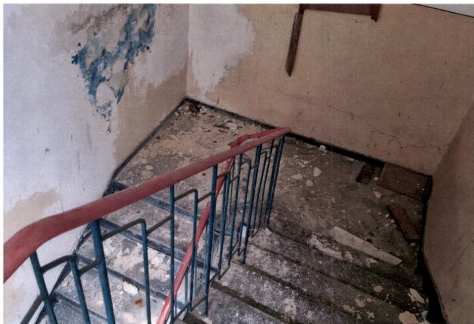
-Fisuri la nivelul peretilor structurali-
