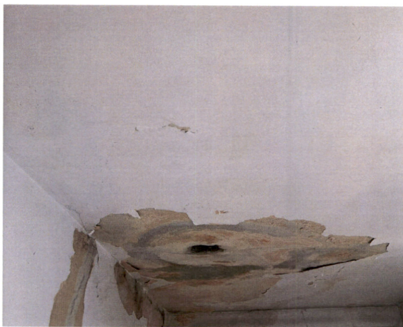
-Fisuri si degradare planseu-
