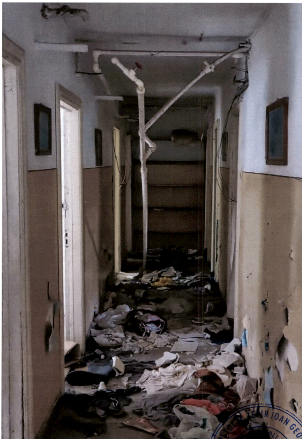
-Trasee instalatii afectate si degradate -
