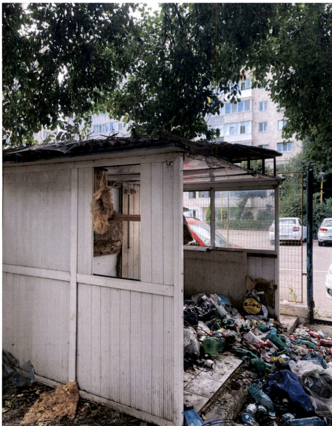
-Stare degradare avansata corp C2-
