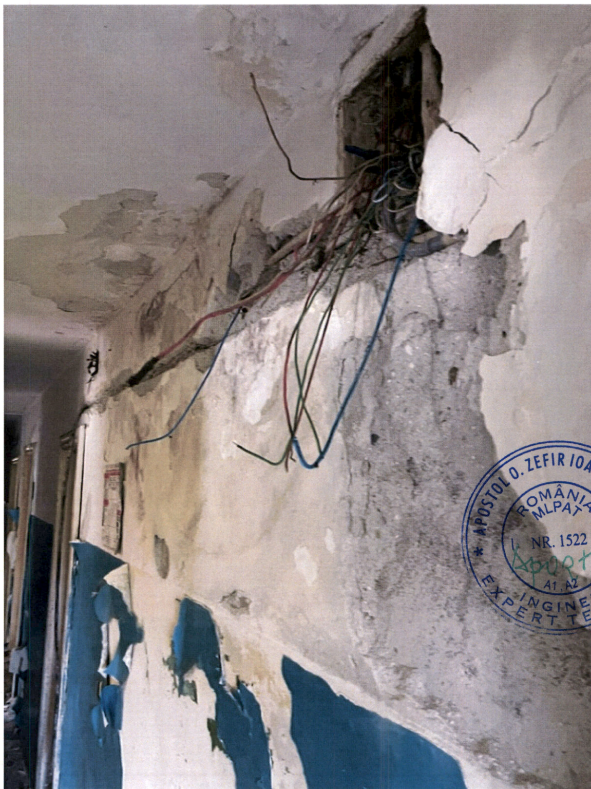
-Trasee instalatii afectate, desprindere acoperire beton-
