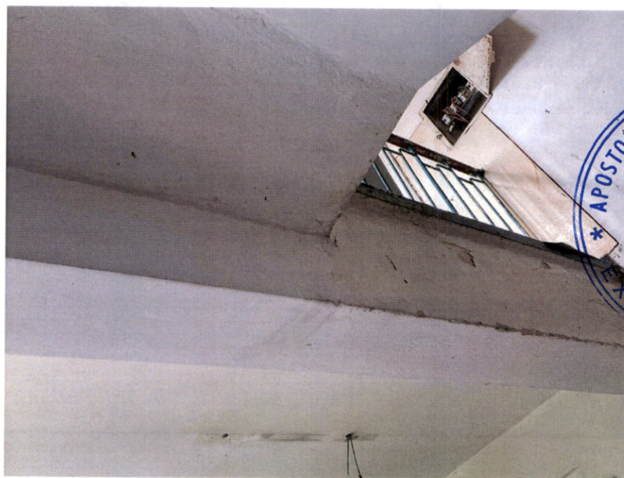
-Fisura in grinda b.a.-
