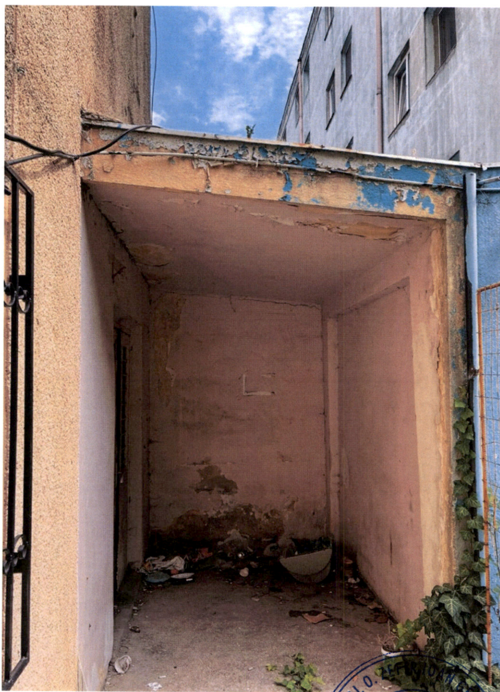
-Desprinderi finisaje, infiltratii si fisuri
