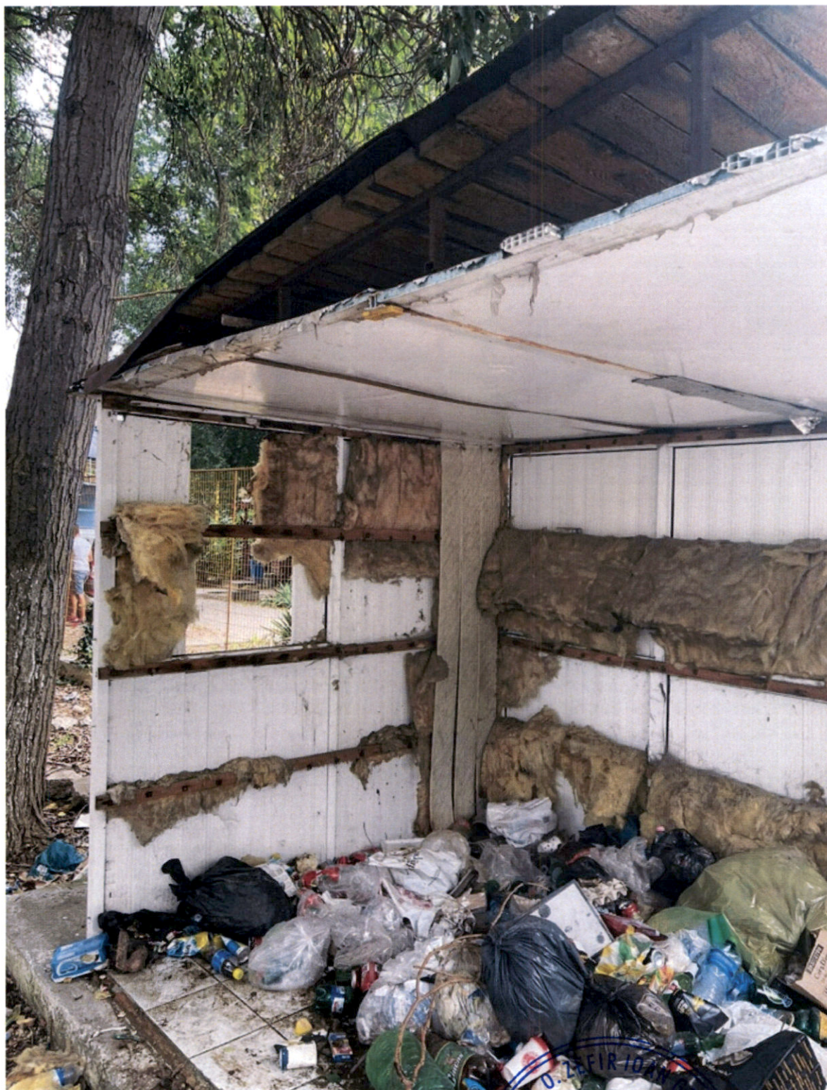
-Stare degradare avansata corp C2
