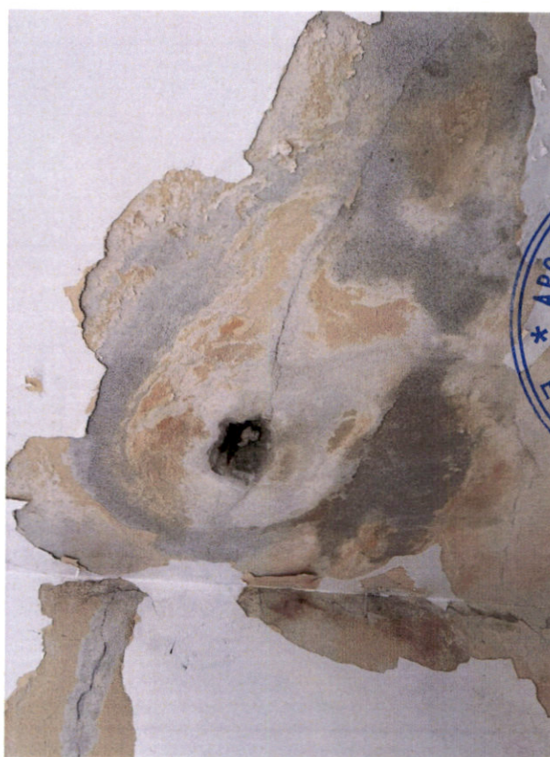
-Fisuri in rostul dintre placa si perete-
