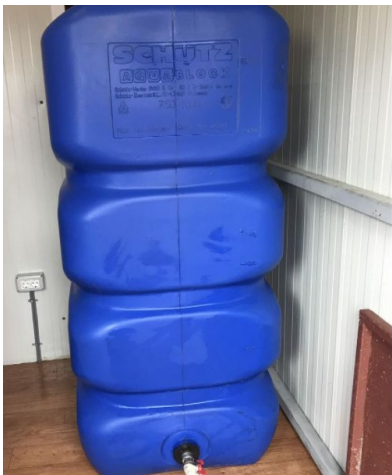
Rezervor apă potabilă
