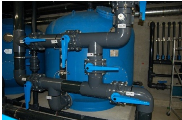
Filtru și pompe
