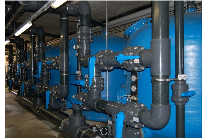
Filtru și pompe
