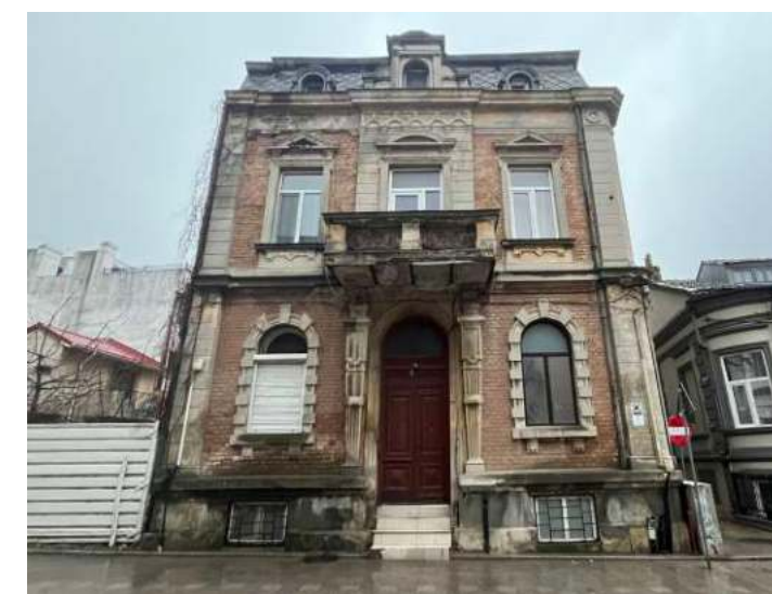
fig. 4 - Monument istoric degradat
