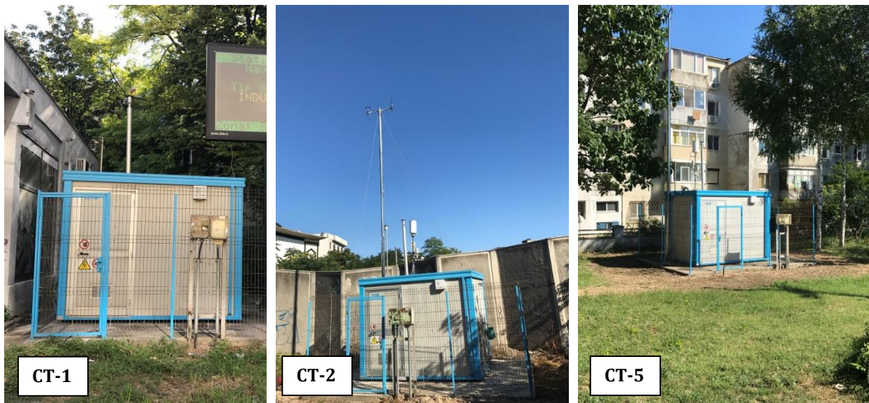
Figura 2-20: Stațiile automate de monitorizare a calității aerului din municipiul Constanța
