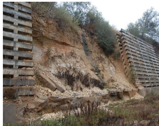
Foto 2 Lipsa tronson zid de protectie din cadre de beton armat prefabricat
