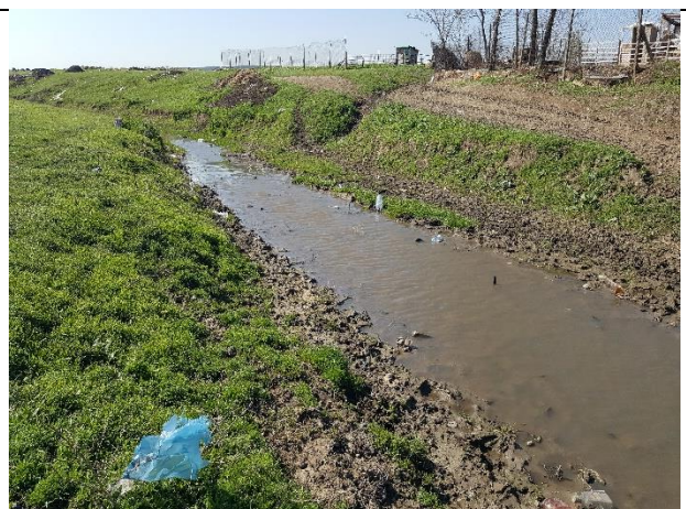
Fig. 39 Aspect al pârâului Săcele din zona de traversare a acestuia pentru montarea liniei electrice de alimentare a SPC
