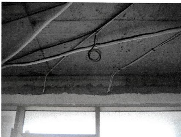
interior parter – instalatii interioare
