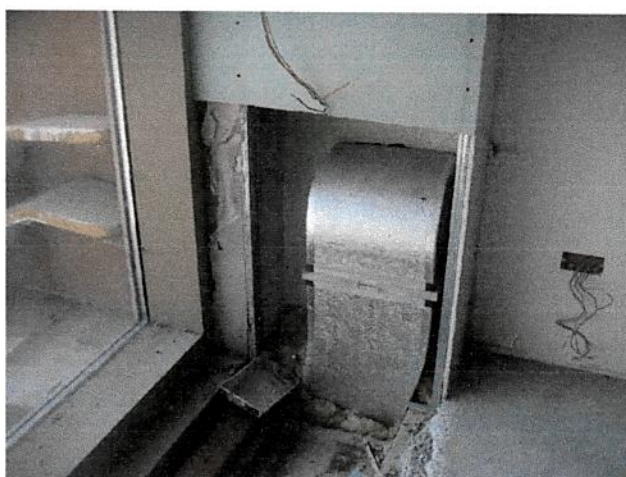
interior parter- instalatii interioare
