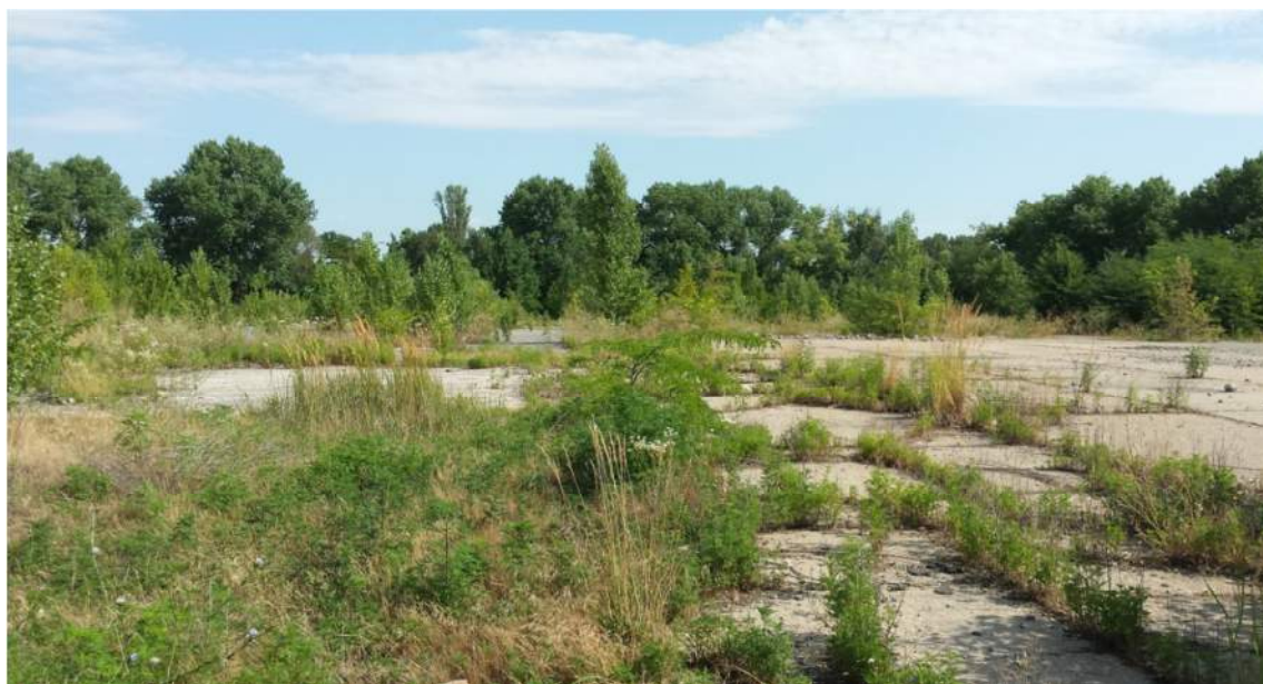
Foto1 : Vedere de pe amplasament –platforma betonată degradată cu vegetație în crăpături
