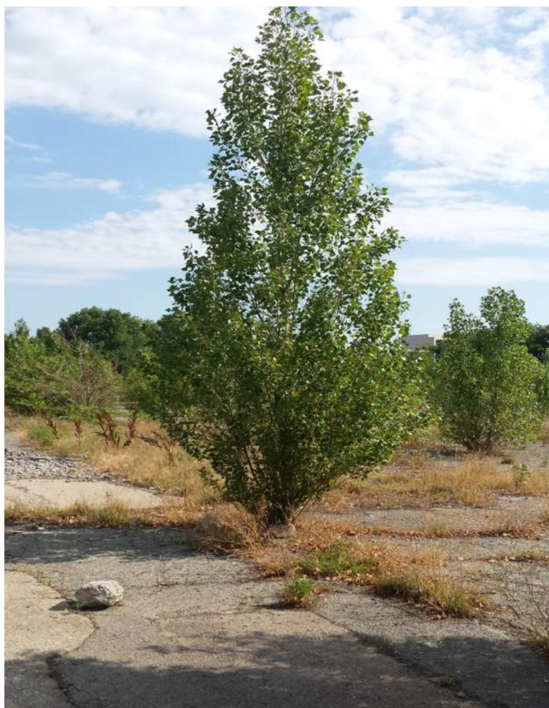
Foto 6: Exemplar de Populus tremula crescut în fisurile din platforma betonată
