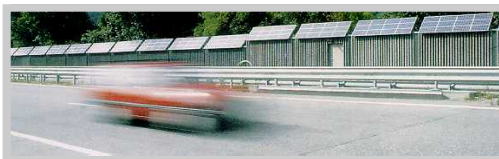
Figura 15: Panouri fotovoltaice încorporate în panourile acustice de pe autostrada N13 din Elveția.
