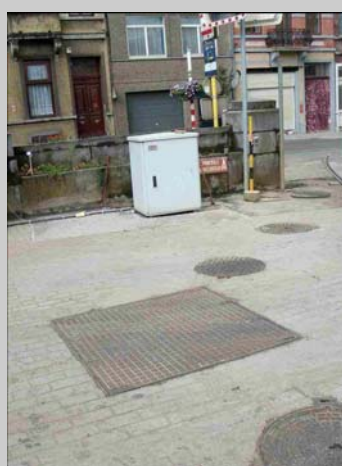
Figura 5: Caseta de control a lubrifianului și unitatea de pompare
